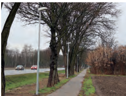
Oświetlenie chodnika w Topołowej
