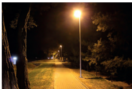
Oświetlenie chodnika przy ul. Sochaczewskiej
