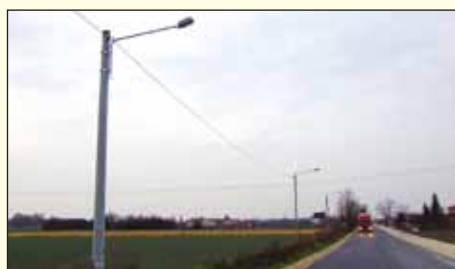
Oświetlenie drogi w Elżbietowie
