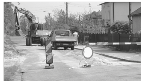
Odwodnienie ulicy Kaskiej
