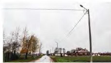
Teresin Gaj – oświetlenie drogi (ul. Tęczowa)
