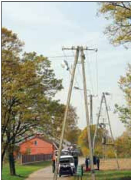
Nowe ciągi oświetleniowe w Gnatowicach
