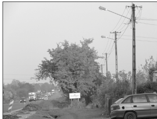
Oświetlenie drogi w Granicach
