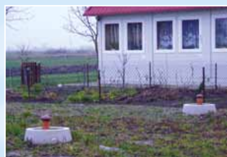
Przydomowa oczyszczalnia przy kontenerze socjalnym w Szymanowie
