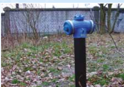
Wodociąg w Paprotni ul. Piaskowa
