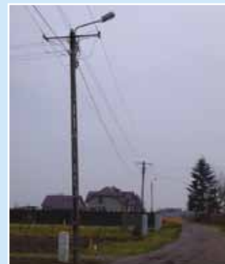
Oświetlenie ul. Kwiatowej w Serokach
