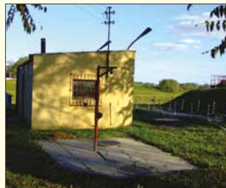
Oczyszczalnia ścieków w Pawłowicach
