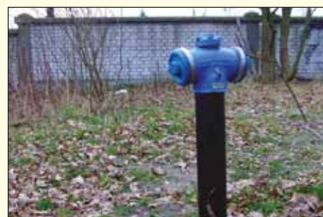
Wodociąg w Paprotni (ul. Piaskowa)
